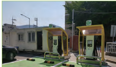
전기자동차 충전 시설
