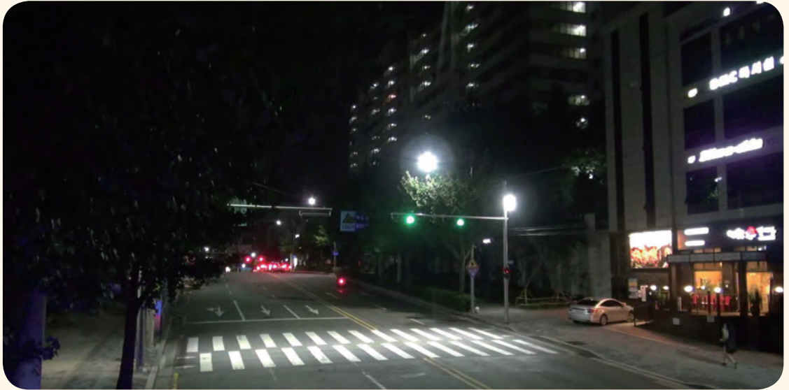
어린이보호구역 내 횡단보도 집중조명시설(투광기) 설치
