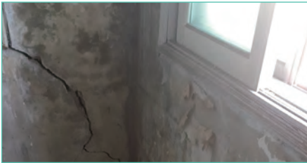
공사중 균열 확인
